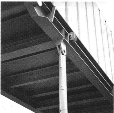
Este edificio de servicios está soportado por un pasador en la parte superior de la columna. (8)
